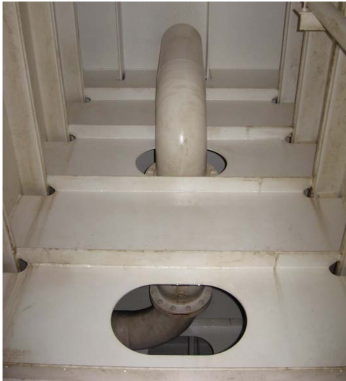
Figure A-4. Overfill line.
